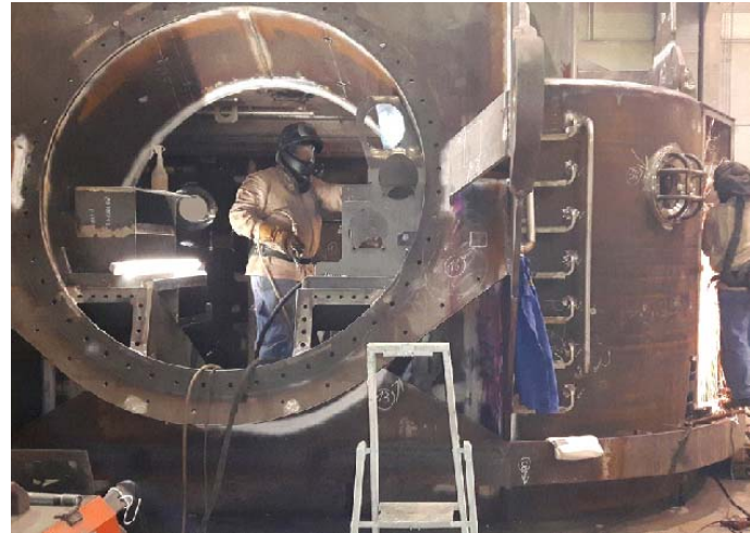
Bild 10: Die neue Taucherglockenanlage hat ein Gesamtgewicht von circa 160 Tonnen und eine Seitentür zum Beladen.
